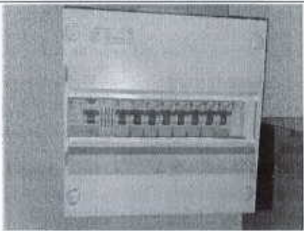
Photo Tableau de répartition
