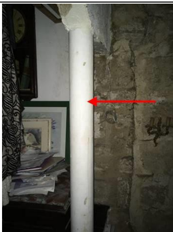
Photo n° PhA001 Localisation : 1er étage - Dégagement Ouvrage : 6 - Conduits et accessoires intérieurs - Vide-ordures Partie d'ouvrage : Conduit en fibres-ciment Description : Conduit en amiante ciment
