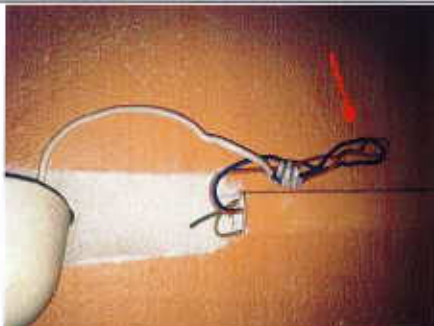
Photo PhEle002 Libellé de l'anomalie : B8.3 e Au moins un conducteur isolé n'est pas placé sur toute sa longueur dans un conduit, une goulotte ou une plinthe ou une huisserie, en matière isolante ou métallique, jusqu'à sa pénétration dans le matériel électrique qu'il alimente. Remarques : Présence de conducteurs électriques non protégés mécaniquement
