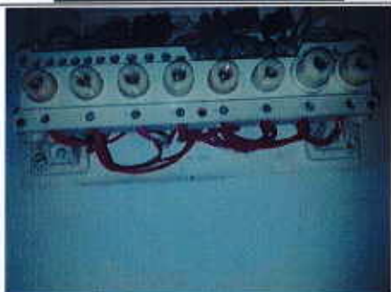
Photo PhEle009 Libellé de l'anomalie : B8.3 a L'installation comporte au moins un matériel électrique vétuste.
