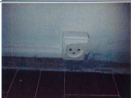
Photo PhEle011 Libellé de l'anomalie : B3.3.6 a1 Au moins un socle de prise de courant ne comporte pas de broche de terre.
