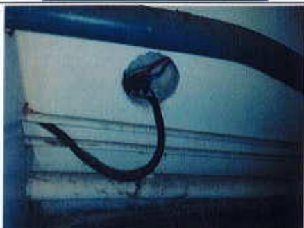
Photo PhEle006 Libellé de l'anomalie : B7.3 d L'installation électrique comporte au moins une connexion avec une partie active nue sous tension accessible.
