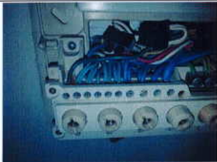
Photo PhEle001 Libellé de l'anomalie : B4.3 c Plusieurs circuits disposent d'un conducteur neutre commun dont les conducteurs ne sont pas correctement protégés contre les surintensités.
