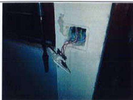
Photo PhEle004 Libellé de l'anomalie : B7.3 a L'Enveloppe d'au moins un matériel est manquante ou détériorée.
