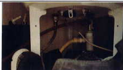
Photo Ele001 Libellé de l'anomalie : B7.3 a L'Enveloppe d'au moins un matériel est manquante ou détériorée.
